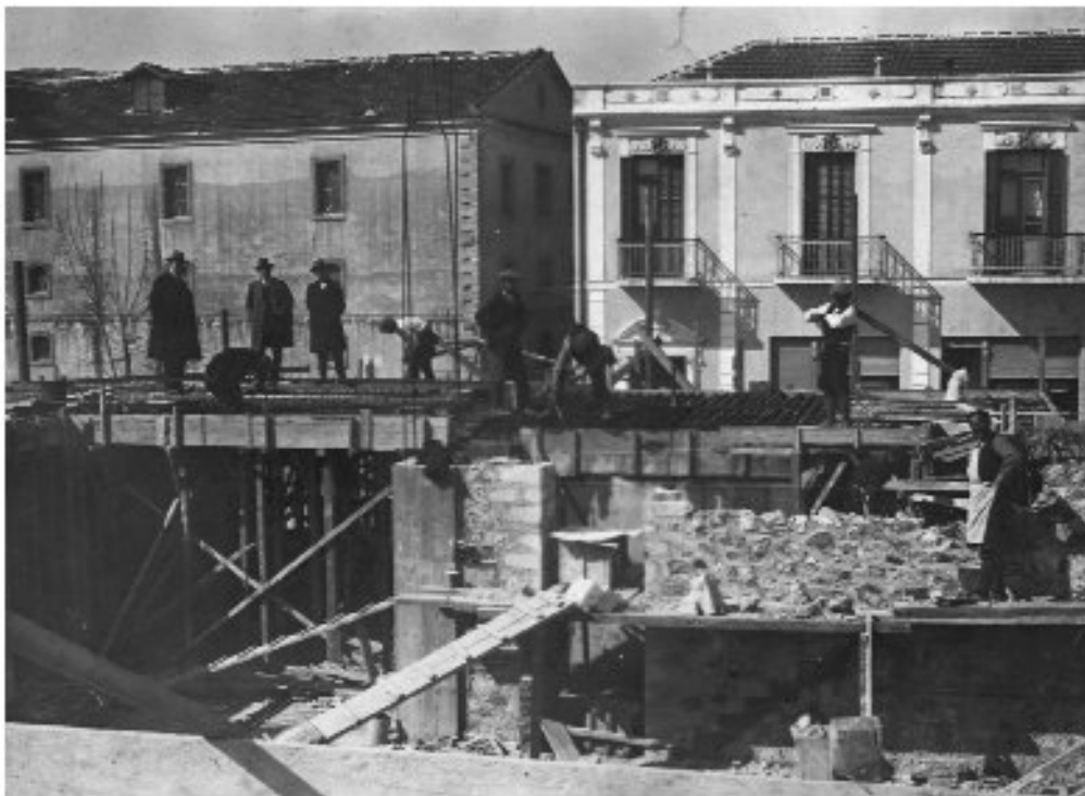
Εικ. 13. Φωτογραφίες κατά τη διάρκεια των εργασιών ανέγερσης. Πάνω: διακρίνονται οι υπάρχουσες οικοδομές στην ανατολική πλευρά του οικοπέδου. Κάτω: διακρίνονται οικοδομές στη βορεινή πλευρά/ μεταξύ των οποίων και νεο-ανεγερθείσα καπναποθήκη (αρχείο Ιω. Ισηγόνη, Ι.Α./Ε.Τ.Ε).
