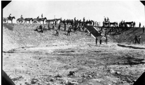
Εικ. 36. Γενική άποψη της δεξαμενής φορτίσεως από το εσωτερικό κατά την κατασκευή της (1936) (αρχείο Γ. Η. Παπάζογλου).
