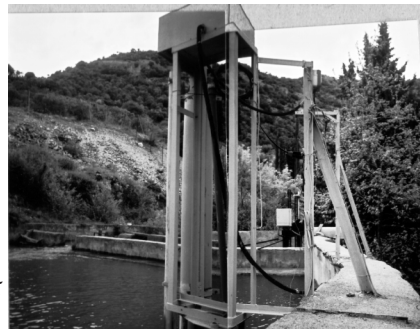
Εικ. 17. Μηχανισμός ένδειξης στάθμης ύδατος στη δεξαμενή.
